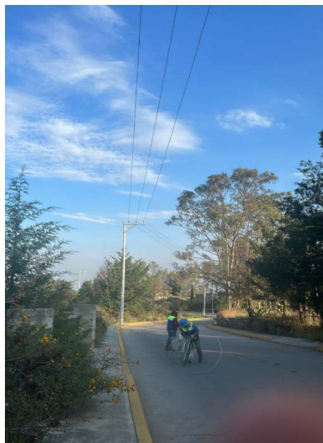
ELECTRIFICACIÓN CALLE LAS PERAS
