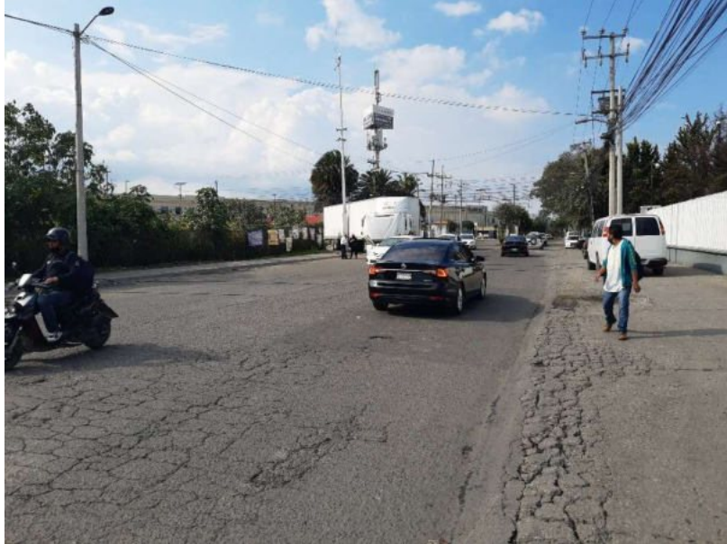
Foto 21. Vista de la Estación 11: Av. Del Convento (Sur – Norte)
